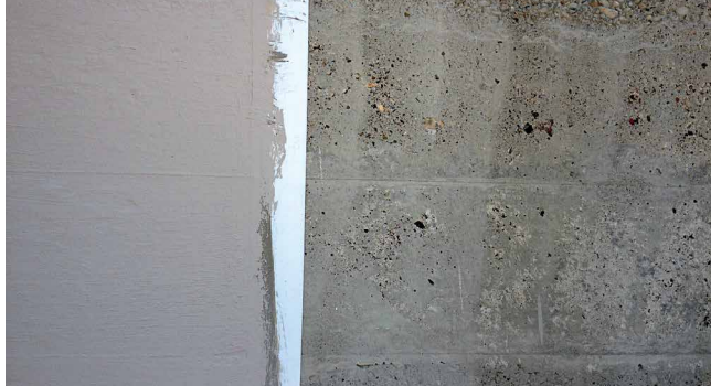
Abb. 3: Senden, Pfarrkirche St. Josef der Arbeiter: gestrahlte Betonoberfläche – Musterfläche zur Anlage eines Oberflächenschutzsystems (Foto: Elke Hamacher)
