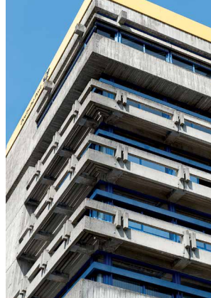
Abb. 1: Marburg, Hauptpostamt – vor der Instandsetzung; Architekt: Johannes Möhrle, 1973 bis 1976 (Fotos: Hessisches Landesamt für Denkmalpflege, Christine Krienke)
