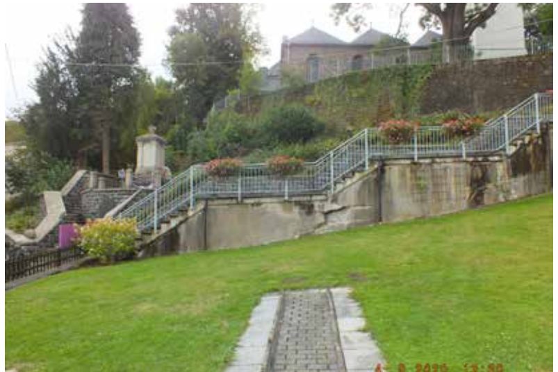
Abb. 9 Treppenwand aus Stampfbeton mit Geländer – zahlreiche Schäden durch viele Faktoren bedingt
