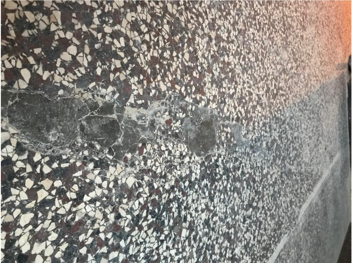
Bild 12: aufgebrochener Füllmörtel an breiterer Fehlstelle, hier bis ca. 50mm breit
