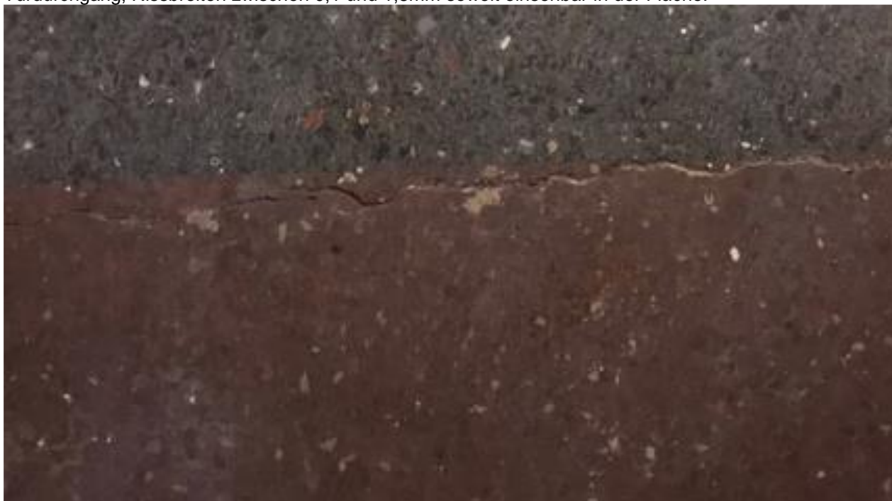
Bild 10: Haarriss an Übergang Fries zwischen den unterschiedlich gefärbten Mörteln im Türdurchgang, Rissbreiten zwischen 0,1 und 1,8mm soweit einsehbar in der Fläche.
