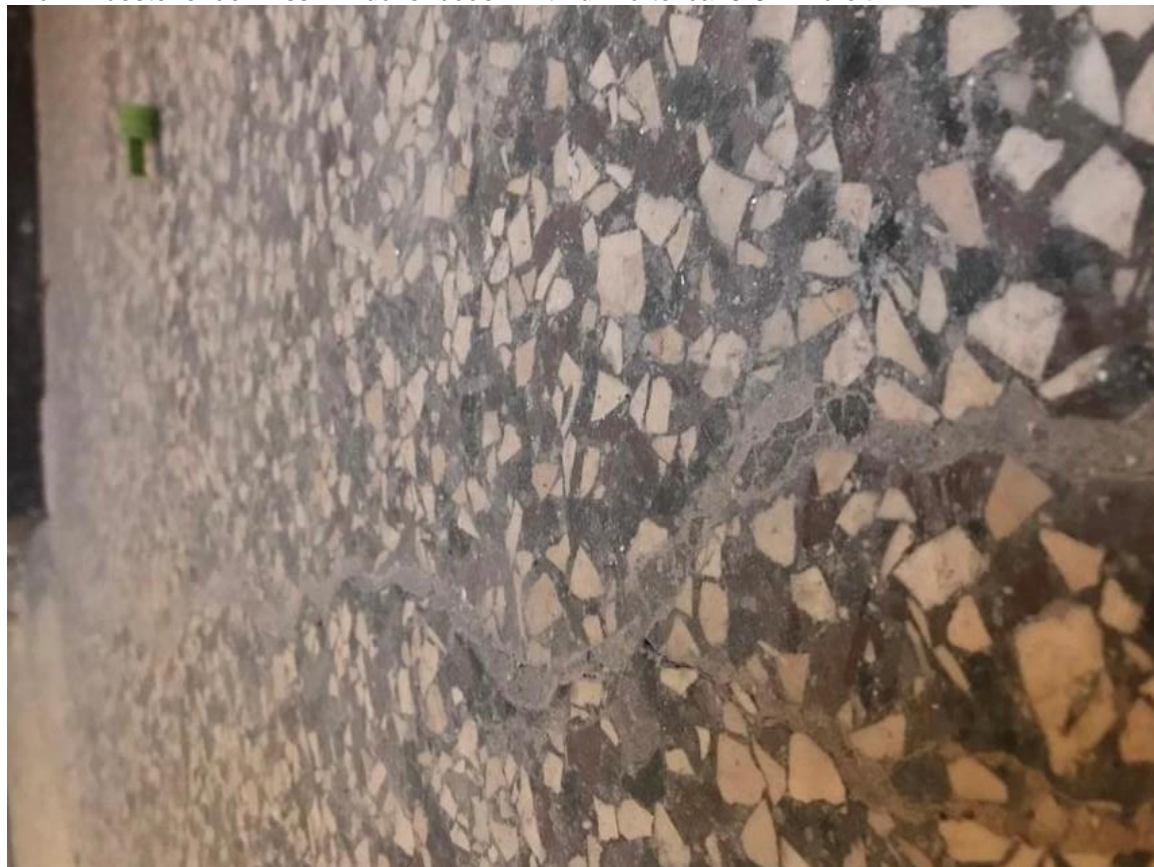
Bild 11: bestehender Riss in Küchenboden mit Füllmörtel ca. 5-8mm breit
